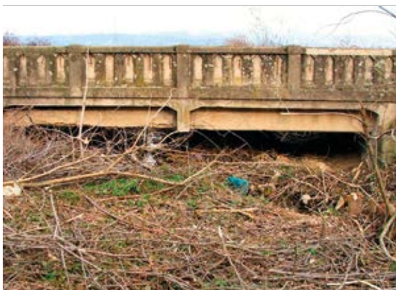
Slika 14: Tipičan primer zagušenja mostovskog otvora koji ometa protok vode
