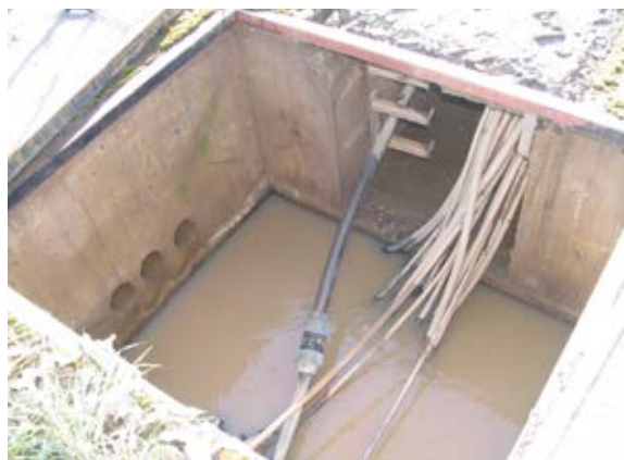
Slika 17: Detalj potopljene komunikacione mreže trafo-stanice
